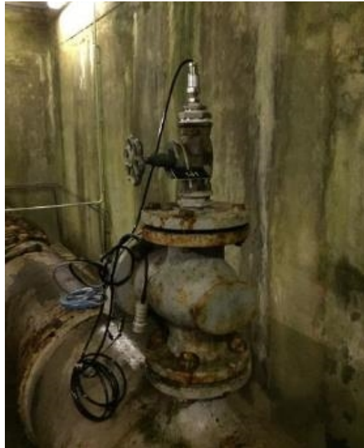
Abbildung 96: Druckmessung am Behälter Rosenhügel, Messstelle Gallgasse
