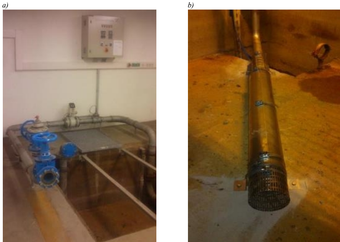
Abbildung 34: Gegebenheiten im Technikum, a) Tiefbehälter inklusive Pumpensteuerungsmodul b) Brunnenpumpe nach Installation
