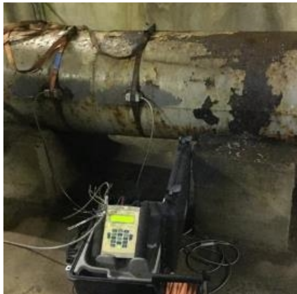
Abbildung 95: Durchflussmessung mittels Ultraschall am Behälter Rosenhügel, Messstelle Gallgasse
