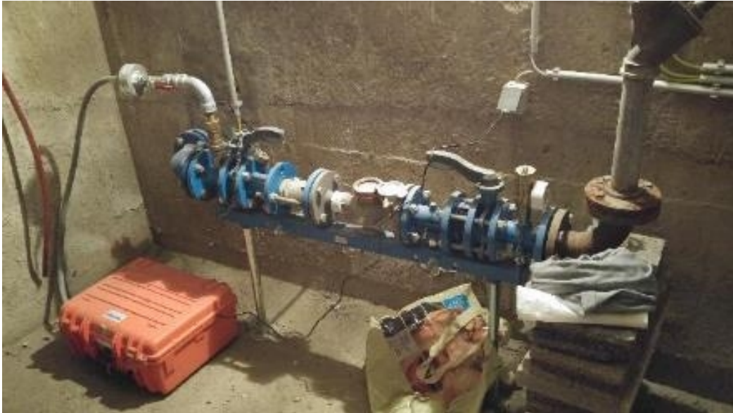
Abbildung 105: Installation eines weiteren Drucksensors mit Stromversorgung vor dem Wasserzähler eines Hauses.
