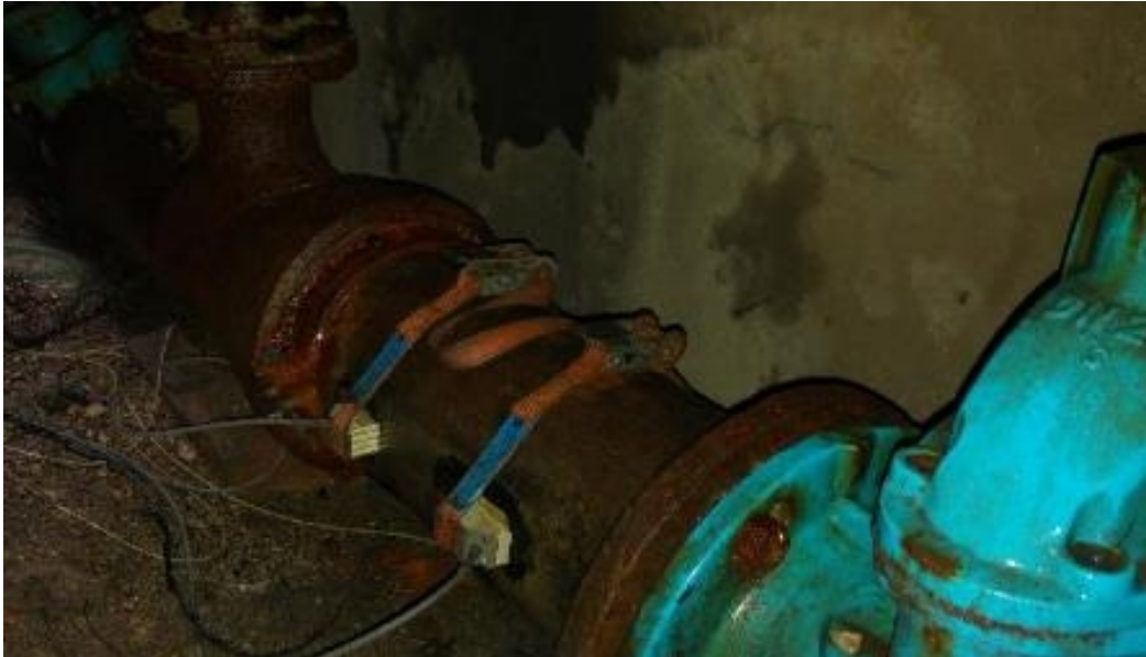
Abbildung 100: Durchflussmessung mittels Ultraschall-Aufsnallmessung an der Messstelle Kaiserpavillon
