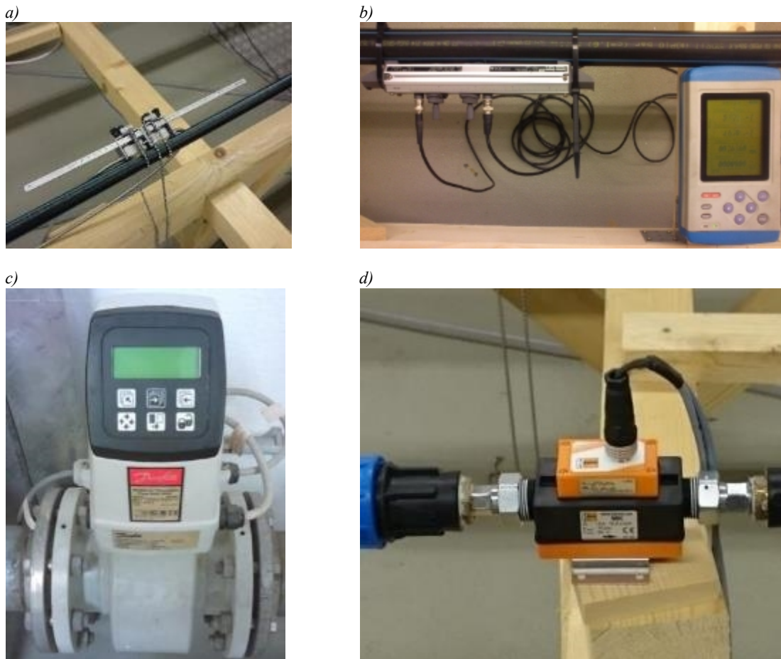
Abbildung 42: Ultraschall-Durchflussmessgeräte unterschiedlicher Hersteller a) Flexim b) Endress und Hauser c) MID am Einspeisepunkt des Labormodells (Danfoss) d) MID zur Messung von Verbrauchern/Leckagen (Kobold)
