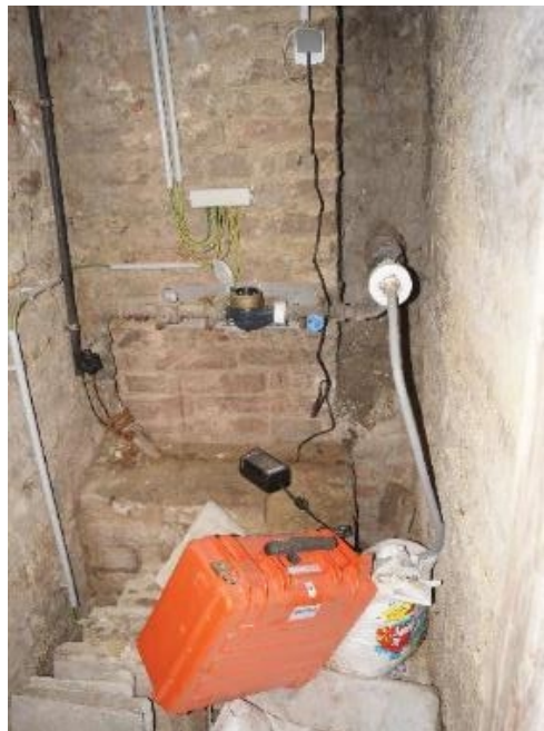
Abbildung 104: Installation eines Drucksensors mit Stromversorgung vor dem Wasserzähler eines Hauses.
